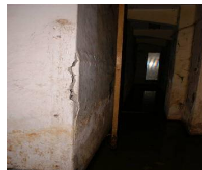
Gambar 4. Pemetaan titik kerusakan struktur lantai dasar (kiri), dan contoh kerusakan pada dinding kasanah dan balok lantai 1 (kanan atas dan bawah)
