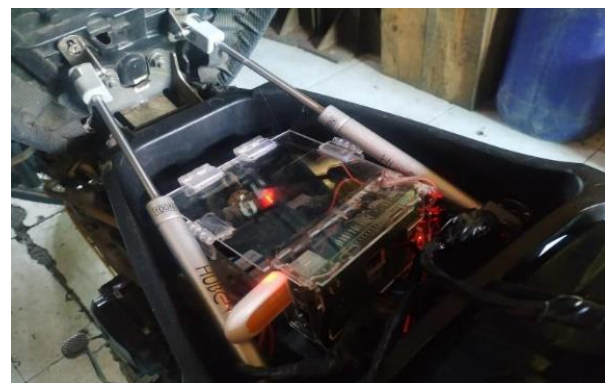
Gambar 2. Ruang MCU pada Bagasi Sepeda Motor
