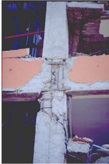
Gambar 58d. Kegagalan Geser Join Kolom-Balok pada Kolom Interior
