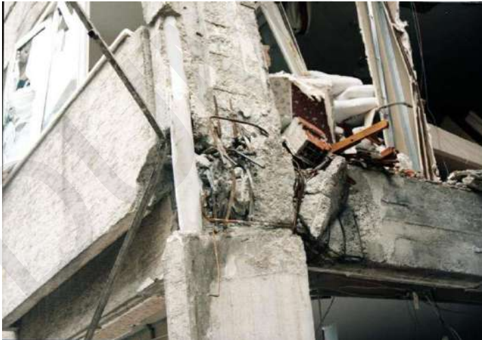
Gambar 58c. Kegagalan Join Kolom-Balok pada Kolom Pojok (Eksterior) Beton Bertulang
