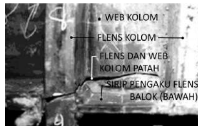
Gambar 66e. Patah pada Flens dan Web Kolom (Panel Zone) di A
