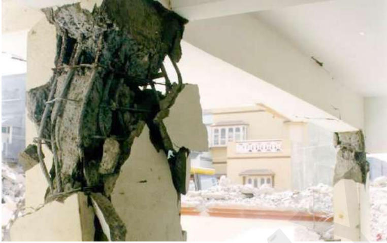
Gambar 58b. Kegagalan Geser Kolom
