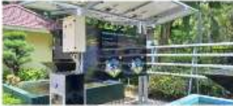
Gambar 9. PLTS Off Grid, Box baterai, dan Box tenaga
