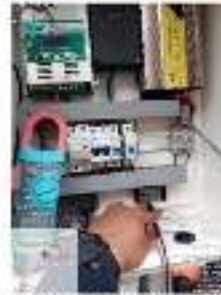
Gambar 13. Pengujian output tegangan dari inverter
