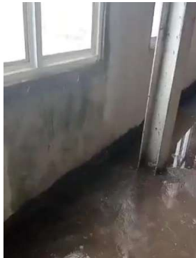
Gambar. 6. Kebocoran Saat Hujan
