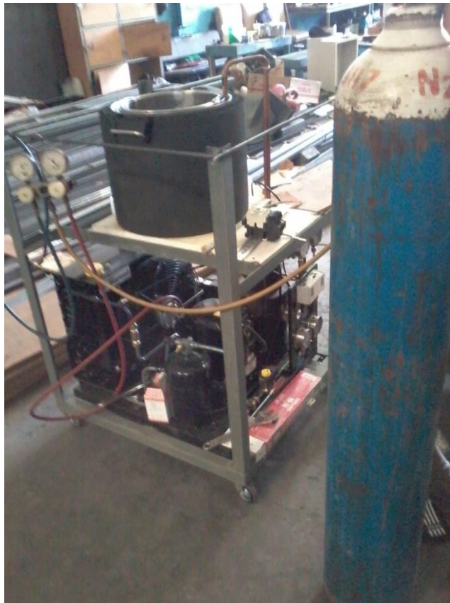
Gambar 5.23 Tes kebocoran sistem pendingin
